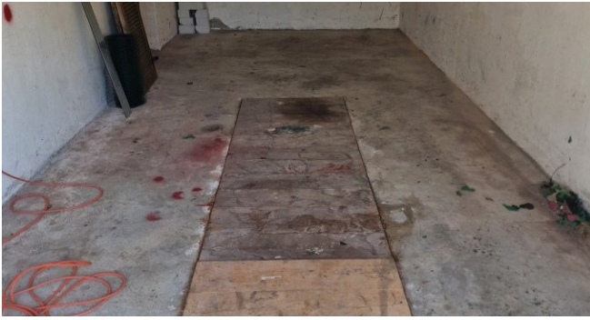
Starkstromanschluss und Grube in der rechten Garag
