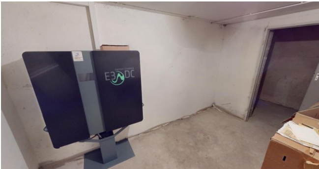
Kellerraum mit PV Anlage
