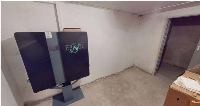
Kellerraum mit PV Anlage
